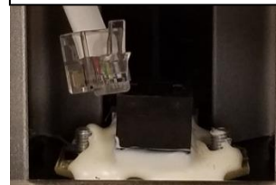
Câble de cellule de pesage non connecté
