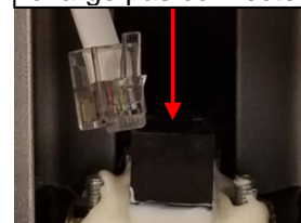
Câble de cellule de charge pas connecté
